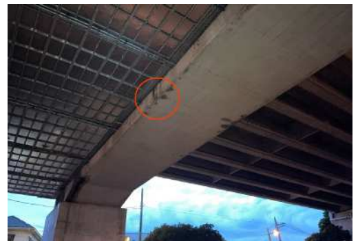
橋脚からの滴下箇所
