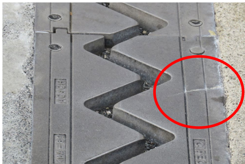
【相模原 IC(内回り)ランプ損傷状況】
