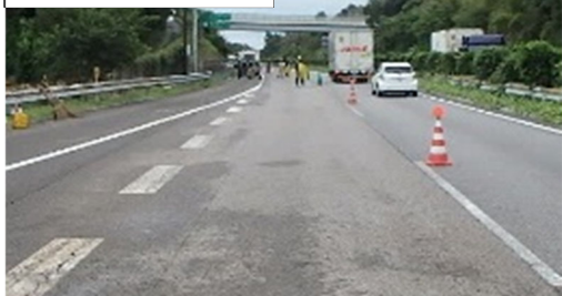
舗装損傷状況
