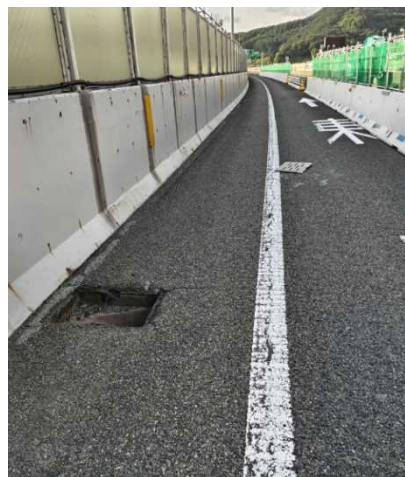
写真: 排水ます蓋の損傷状況
