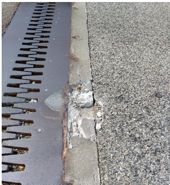
現場で確認した、舗装と橋梁との継ぎ目箇所の損傷
