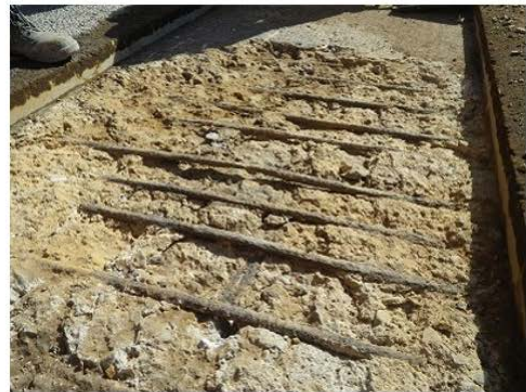
床版上面の損傷状況
