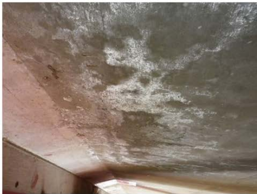
床版下面の損傷状況
