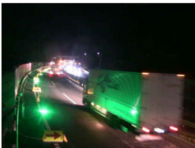
視線誘導の設置例
