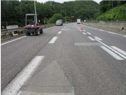
舗装損傷状況
