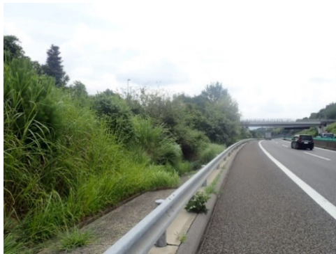
草木繁茂状況
