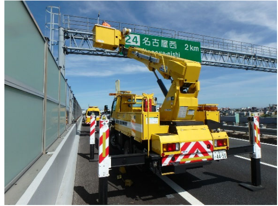
通信設備の点検
