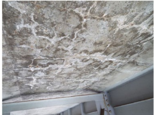
< 中村川橋の損傷状況 >
