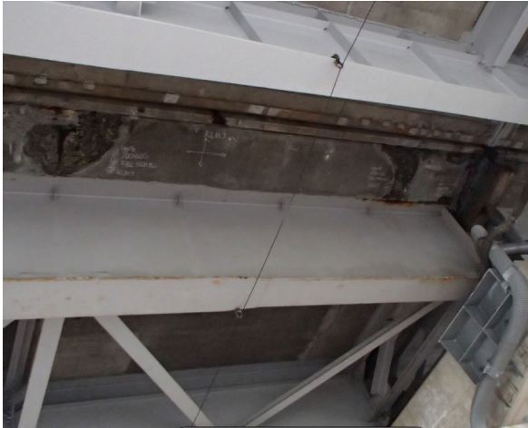
< 矢作高架橋の損傷状況 >
