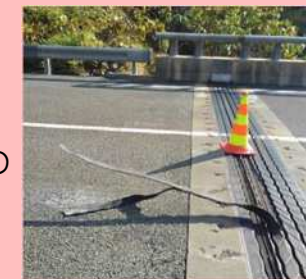
伸縮装置の変状
