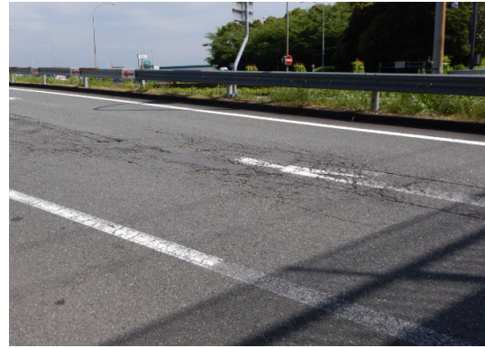
愛鷹 PA（上り線出口）の舗装劣化状況
