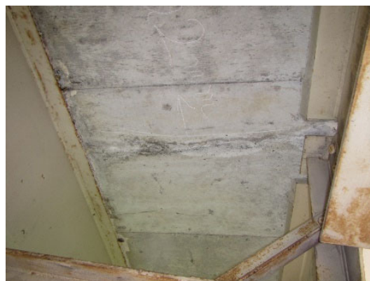
<酒匂川橋の劣化状況>
