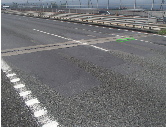
第二走行車線の舗装劣化状況
