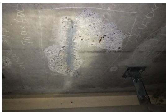
<滝沢川橋の劣化状況>
