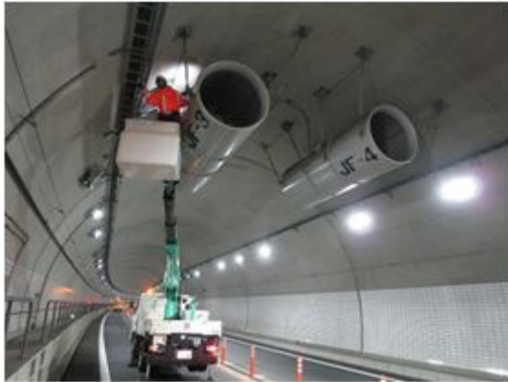
<ジェットファン点検状況>
