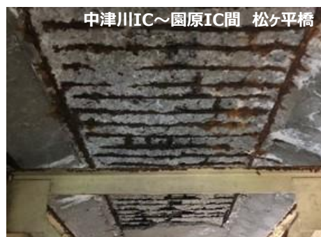
中津川IC～園原IC間 松ヶ平橋 床版下面のはく落・鉄筋の腐食
