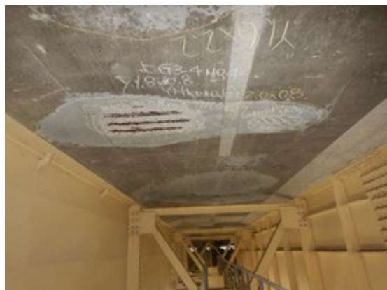
床版下面コンクリートの剥離状況 (田添高架橋)
