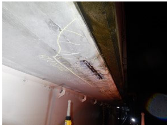
床版張出部下面コンクリートの剥離状況 (桐山川橋)
