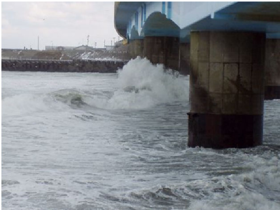
波しぶきを受けている状況 本橋は厳しい塩害環境下にある
