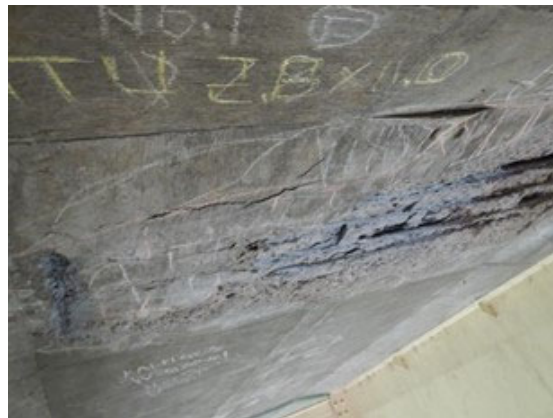
床版下面コンクリートの剥離状況 (足羽川橋)
