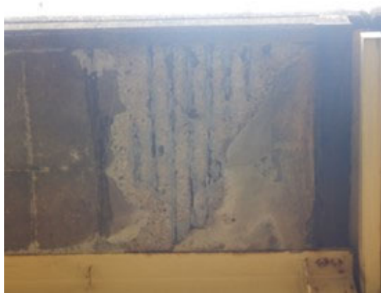
床版下面コンクリートの剥離状況 (金沢高架橋)
