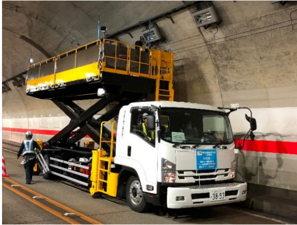
《設備清掃・点検》
