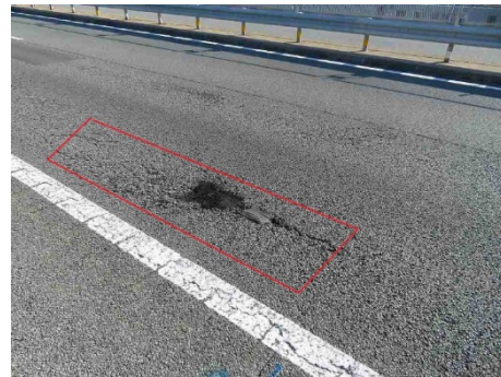
路面の損傷状況
