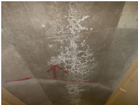
床版下面の損傷状況
