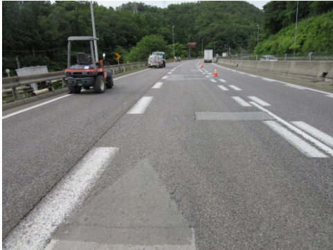
舗装損傷状況
