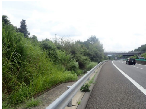
樹木繁茂状況
