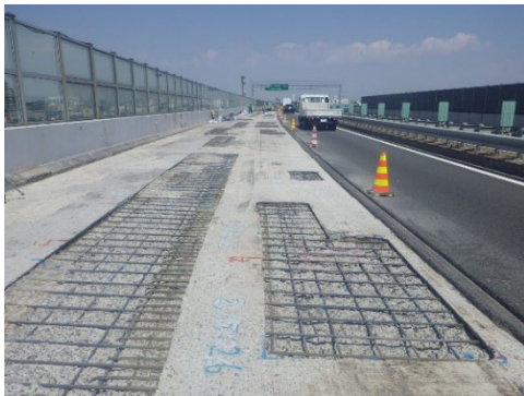
コンクリート床版損傷状況
