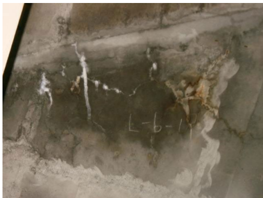
所領橋の床版劣化状況
