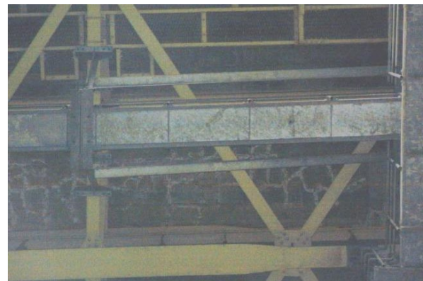
滝沢川橋の床版劣化状況
