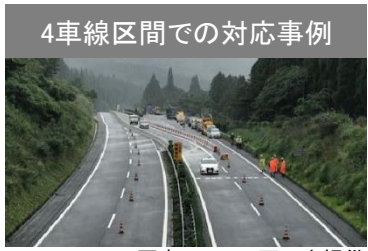
写真:NEXCO西日本提供 大分道では、「令和2年7月豪雨」により、上り線が被災しましたが、4車線であったため、下り線を活用して早期に交通を確保できました。
