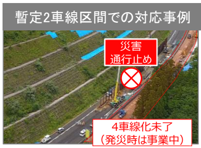
「平成30年7月豪雨」により、東海北陸道(暫定2車線区間)および平行する一般国道156号などで、災害による通行止めが発生しました。
