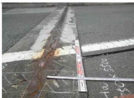
老朽化した伸縮装置(イメージ)
