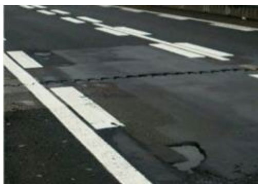
舗装の損傷状態イメージ
