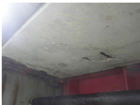
鴨池川橋の損傷状況
