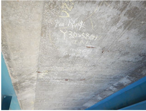
和田川橋の損傷状況
