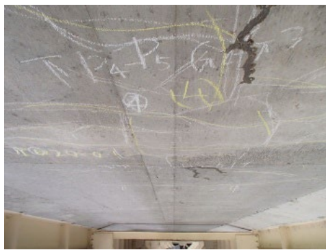
九頭竜川橋の損傷状況
