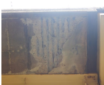
金沢高架橋の損傷状況
