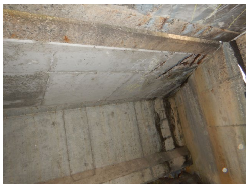
金粕川橋の損傷状況
