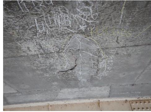
常願寺川橋の損傷状況
