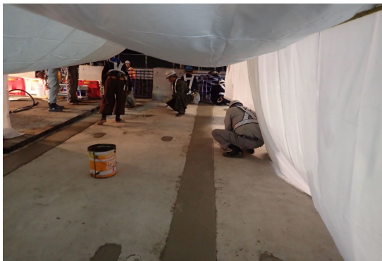
【雨天対策設備設置状況】
