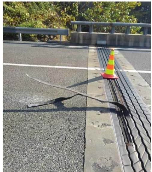
橋梁伸縮装置の破損状況
