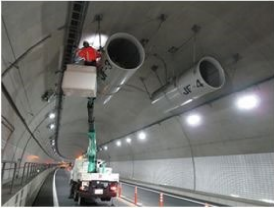
<ジェットファン点検状況>
