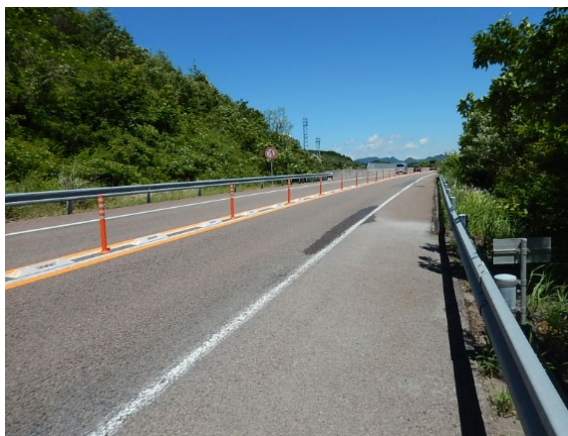
舗装損傷状況
