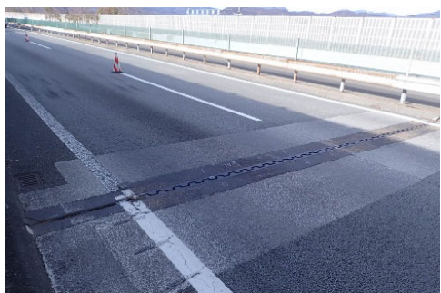
老朽化した伸縮装置(イメージ)
