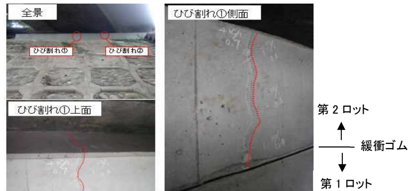
図 2 緑橋 A1 橋台のひび割れの状況
