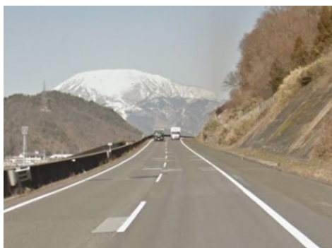
舗装損傷状況
