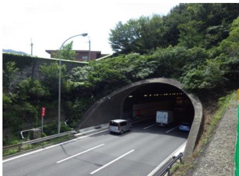
樹木繁茂状況
