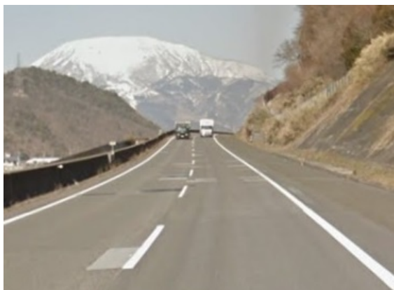
舗装損傷状況
