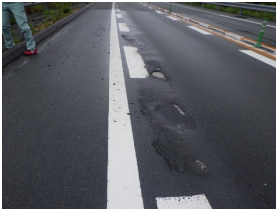
舗装損傷状況
