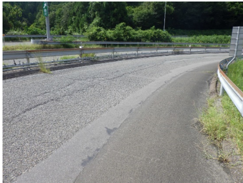
(舗装損傷状況)
