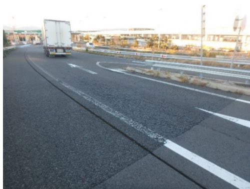
舗装老朽化状況
