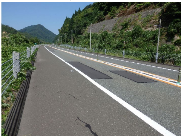
《舗装損傷状況》
