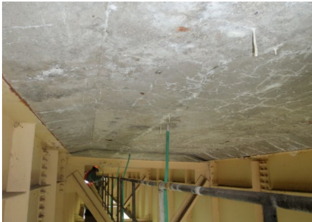
床版裏側の状況（多数のひび割れあり）
