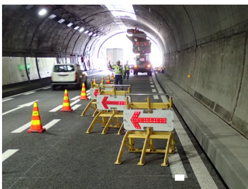
【物理的防御装置設置状況】
