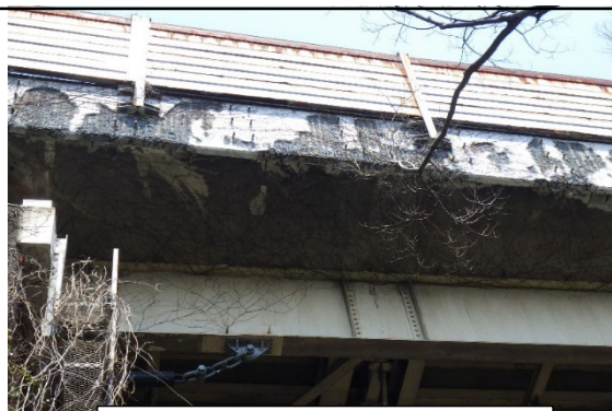
橋梁劣化状況
