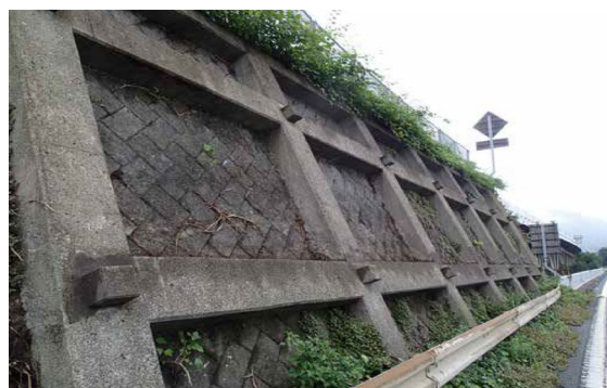
劣化したアンカーを有するのり面
