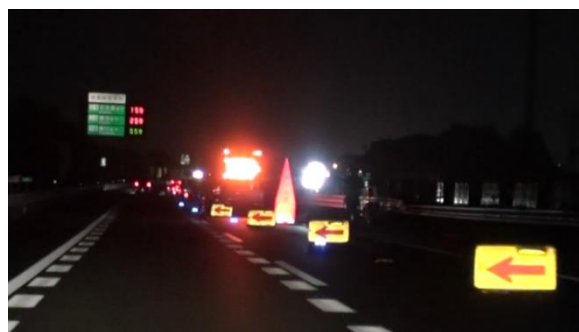
(テーパー部照明の設置例)
