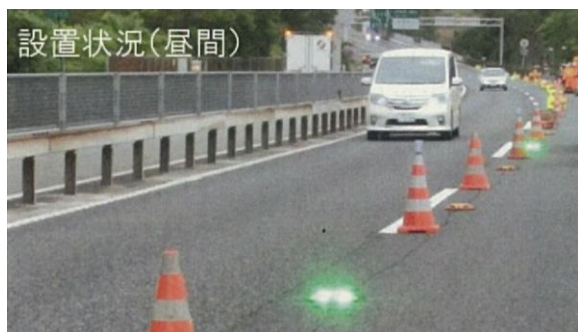
(視線誘導の設置例)
