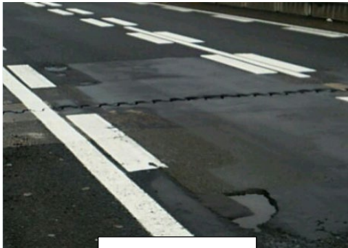
舗装損傷状況
