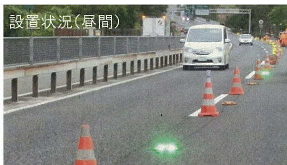
(視線誘導の設置例)
