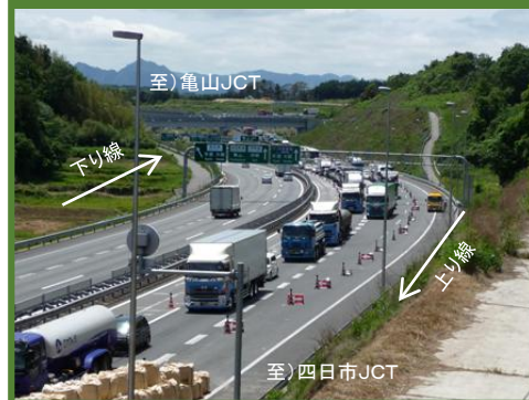
※亀山JCT付近の切土のり面崩落時の復旧工事による渋滞(2010.5)
