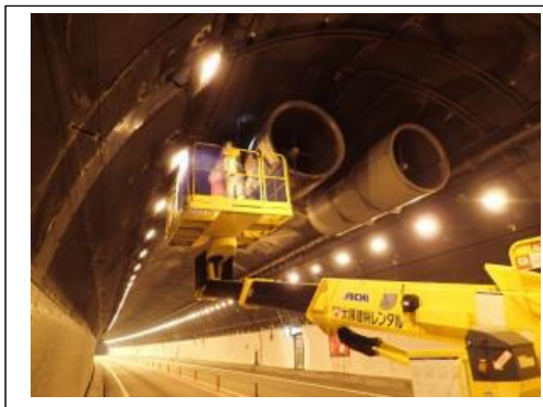
(トンネルジェットファン点検)
