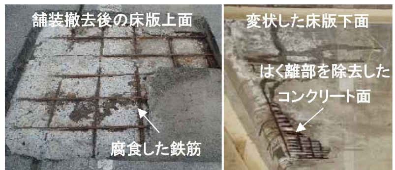
【写真 11】橋梁の鉄筋コンクリート床版の塩害劣化事例（※2）
