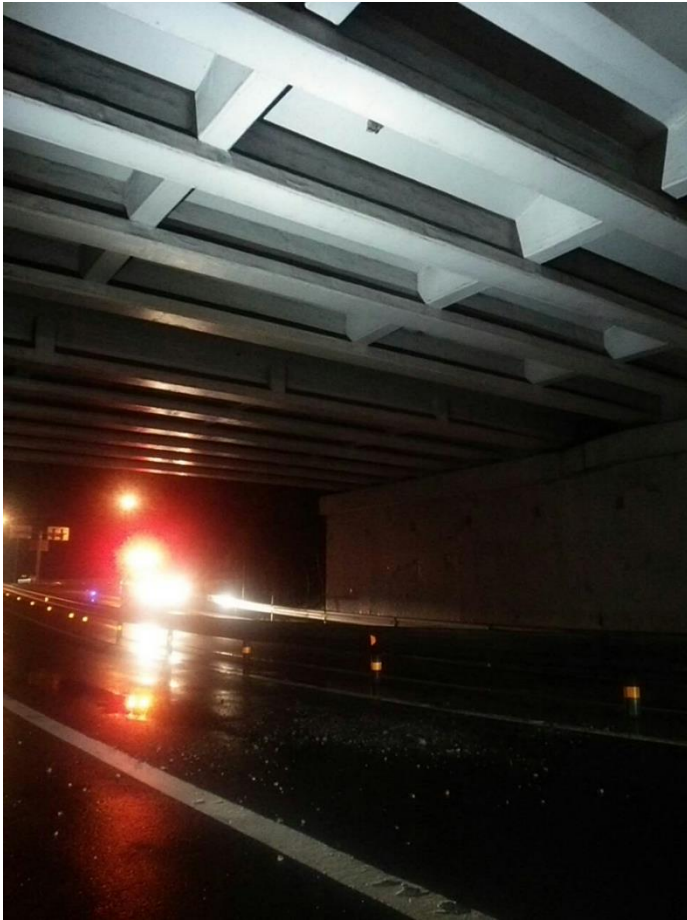
【骨材が落下した状況（鈴鹿 IC 下り線出口ランプ）】
