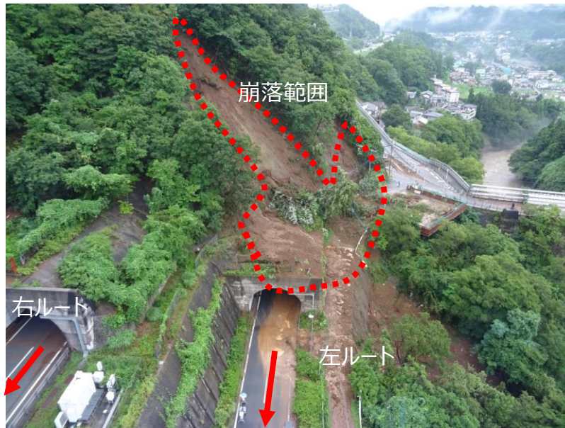
【写真1】岩殿トンネル出口付近の被害状況 8月8日ドローンによる空中撮影
