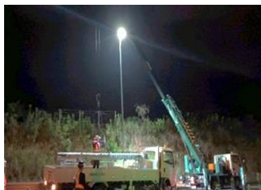
＜道路管理用カメラ設置状況＞
