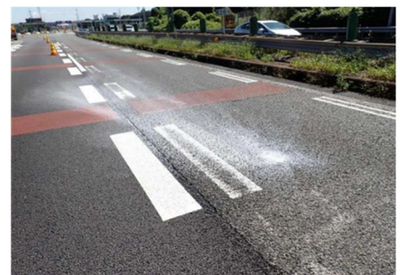
路面標示塗料の飛散状況
