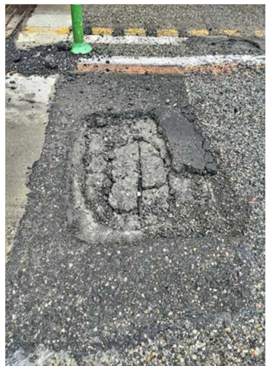
舗装損傷の状況(近景)
