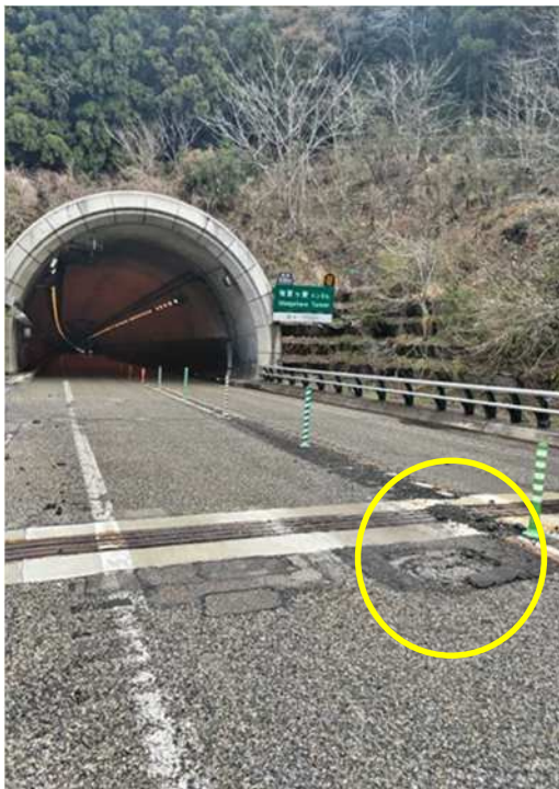
現場の舗装損傷の遠景(車線の右側)
