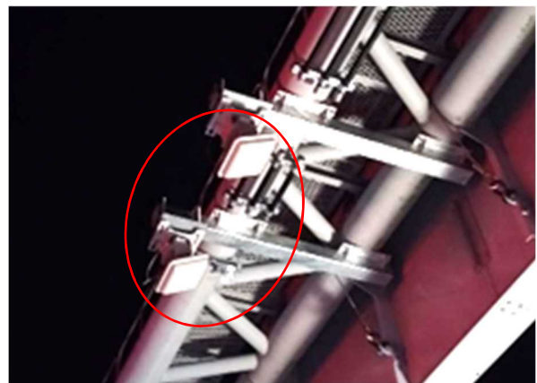
ETC 無線通信専用アンテナ(施工後)
